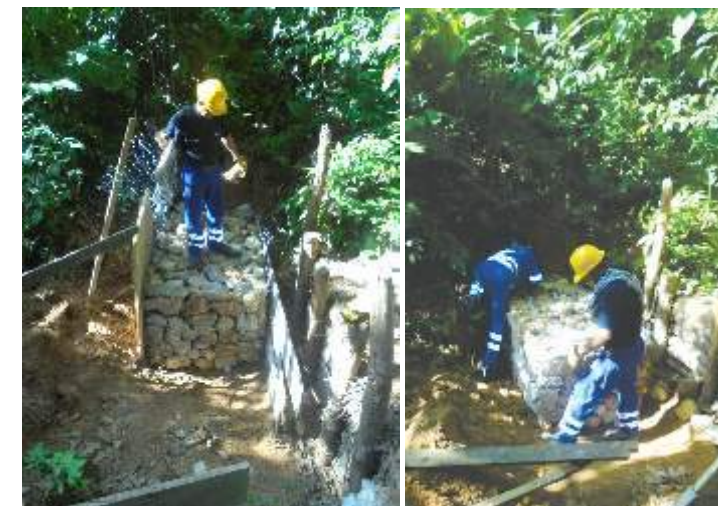
Construcción de estructura (gavión para la estabilización de zona de disposición material de excavación predio de la vereda el 50)
