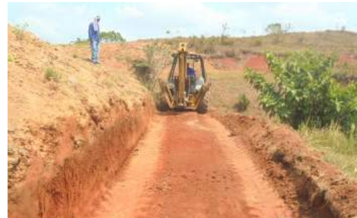
Conformación de la banca en el predio La cabaña del municipio de Caucasia para construcción de una estructura de retención (gaviones)
